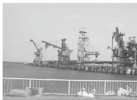
破損した荷受棧橋のアンローダー
